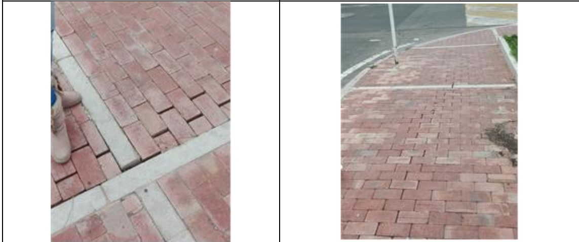
Foto 3 y 4. Sendero peatonal, que presenta separación del adoquín, las juntas no se encuentran completamente llenas con material de sellamiento.
