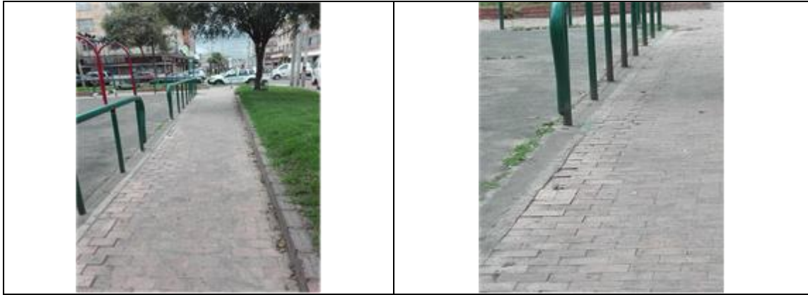
Foto 1 y 2. Sendero peatonal, que presenta separación del adoquín, deformación en la superficie del acabado.
