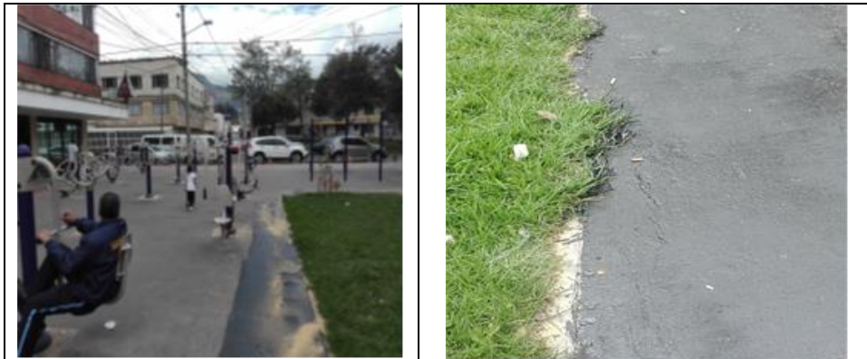
Foto 7 y 8. El pavimento flexible presenta fallas longitudinales.
